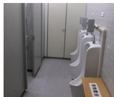
通路が狭いトイレ
