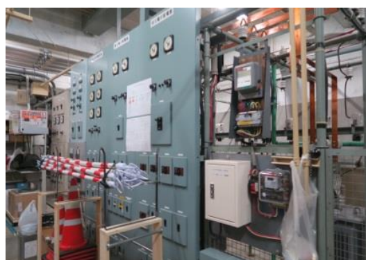
旧式の電気設備
