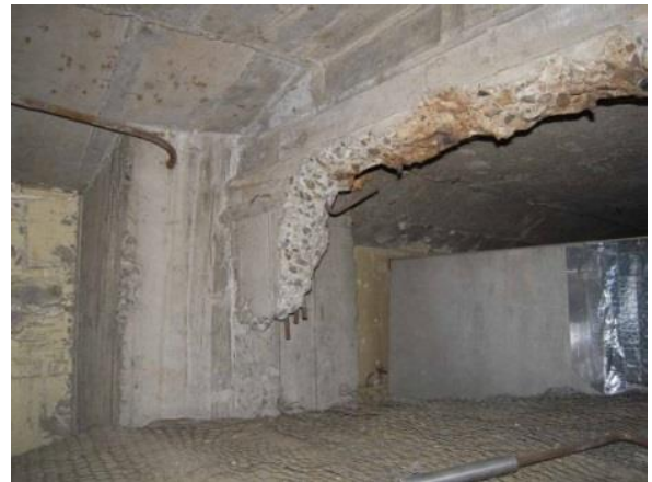
コンクリートの破断
