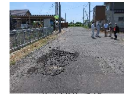
道路補修要望（舗装補修）
