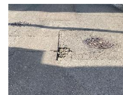
道路補修要望 （舗装補修）
