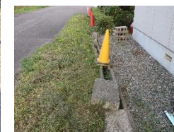
側溝整備要望 （側溝補修）
