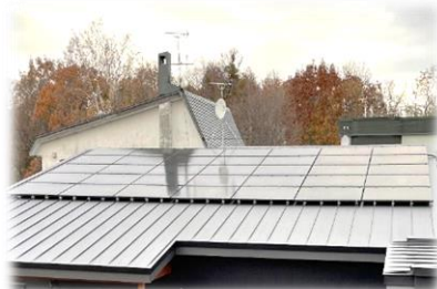
太陽光発電システム設置事例 （脱炭素・環境対策事業）
