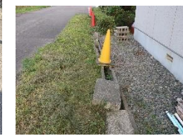
側溝整備要望 (側溝補修)
