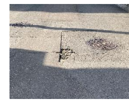
道路補修要望 (舗装補修)
