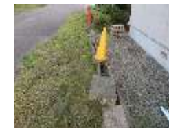
側溝整備要望 （側溝補修）
