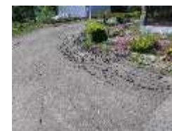
道路補修要望 （舗装補修）
