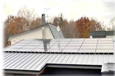
太陽光発電システム設置事例 （環境対策事業）
