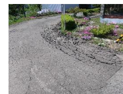
道路補修要望 （舗装補修）
