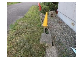
側溝整備要望 (側溝補修)
