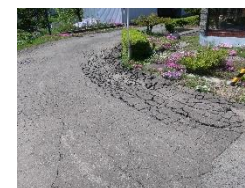
道路補修要望 (舗装補修)
