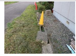
側溝整備要望 (側溝補修)
