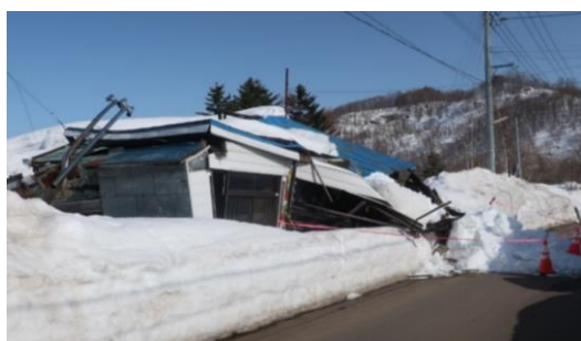
倒壊した空き家
