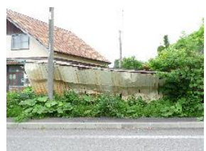
③物置が倒壊している
