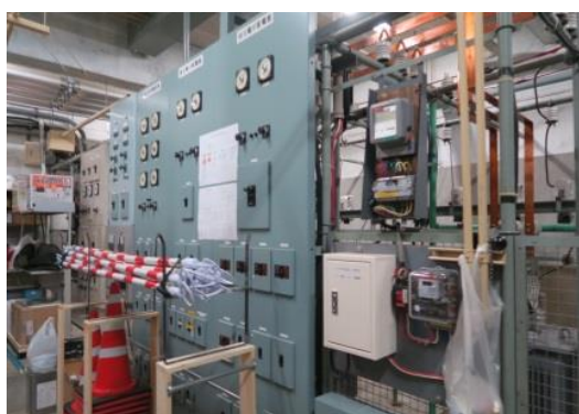
旧式の電気設備
