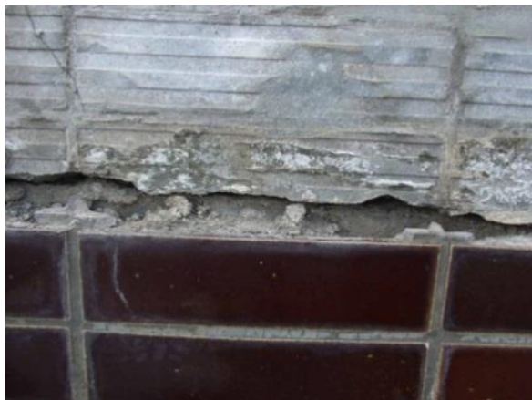
外壁タイルのはく落とコンクリートのひび割れ
