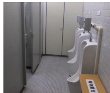
通路が狭いトイレ
