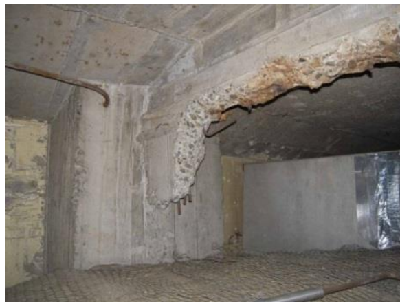
コンクリートの破断
