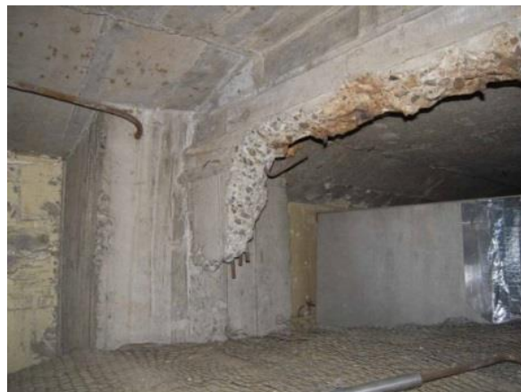
コンクリートの破断
