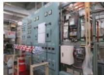
旧式の電気設備
