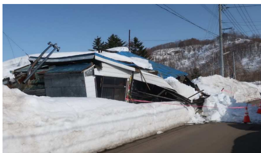
倒壊した空き家
