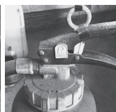
老朽化した消火器
