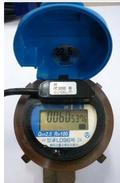
地下メーターボックス内に設置
