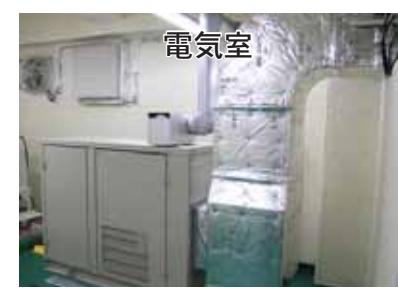
電気室 72時間対応可能な非常用発電装置を備えています
