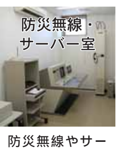
防災無線・サーバー室 防災無線やサーバーを備えています
