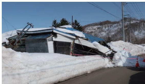
倒壊した空き家
