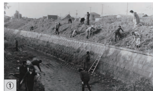
昭和 56 年 8 月 洪水 (幌向市街・高野団地)
